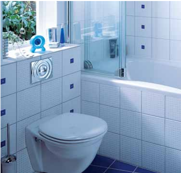
WC com instalação por baixo de uma janela.
